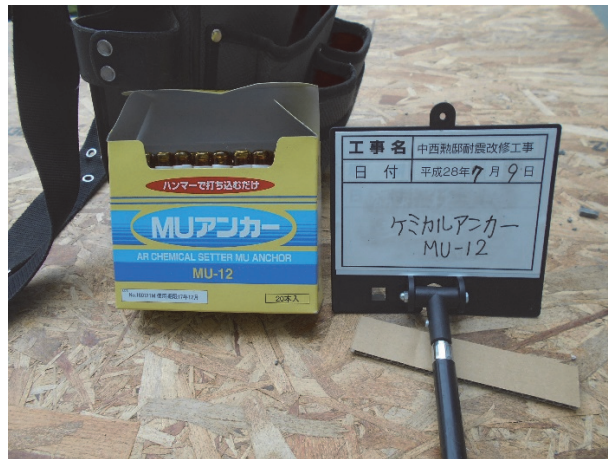
ケミカルアンカー M12 用
