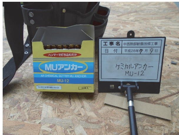
ケミカルアンカー M12 用
